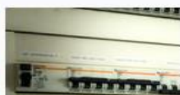
INSTALACIONES Y CONTROL
