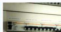
INSTALACIONES Y CONTROL
